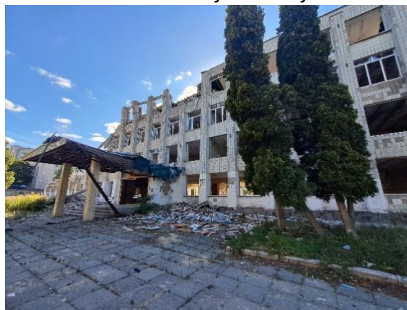
Obrázek 3: Vybombardovaná budova základní školy v Žitomyru
